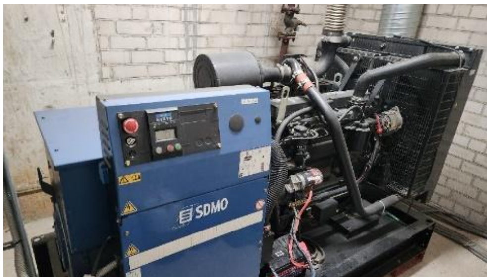
2 pav. Elektros generatorius centrinėje Skuodo šilumos katilinėje.
