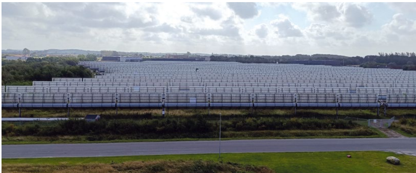
Koncentruotų saulės kolektorių šilumos jėgainė Brøndersleve, Danijoje
