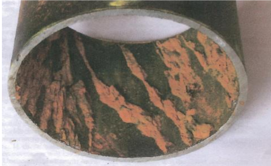
Korozija dėl žemos pH reikšmės ir didelio deguonies kiekio sistemos papildymo vandenyje
